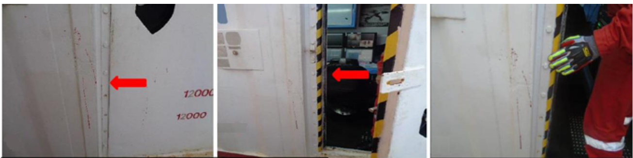
Image 1 - ROV Control Van door frame
